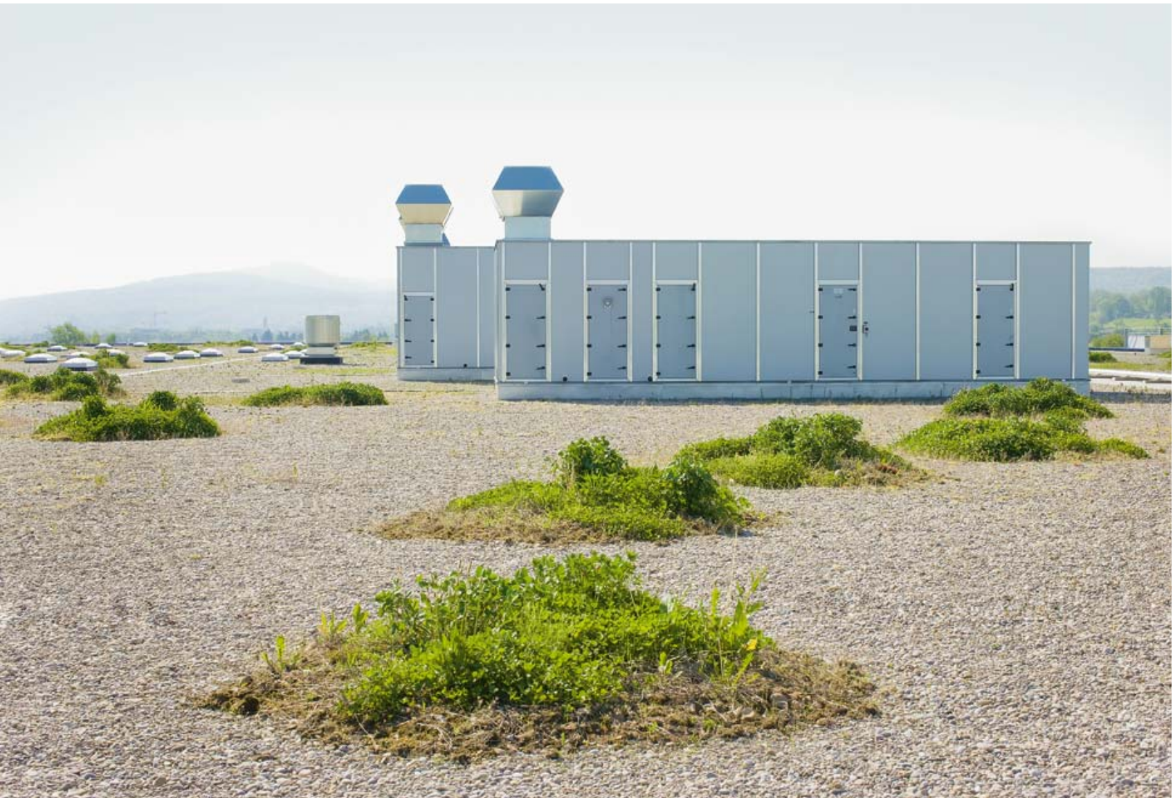
L'efficacité énergétique est assurée par une installation solaire de 150 mètres carrés extensible, placée sur le toit du bâtiment, à Spreitenbach. Le toit est orné d'une couverture végétale qui permet de compenser l'espace vert perdu. Ces îlots de verdure constituent l'habitat de microorganismes.
